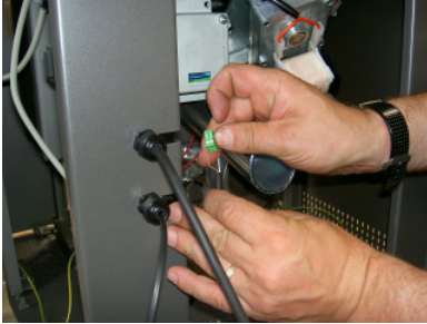
Bild 4: Tele Control, Rückwanddurchführung, Kabelverlegung
